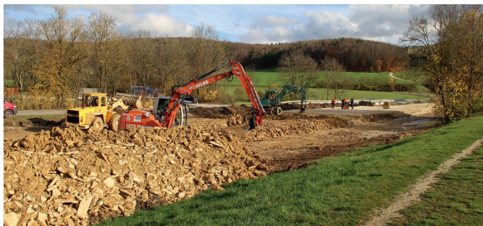
Umfangreiche Erdarbeiten waren für den Weiterbau der Museumsbahn bis zur künftigen Haltestelle Katzenstein notwendig.
