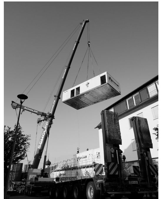
Ende August wurden mit einem speziellen Schwerlastkran 26 Module der Fa. ADK Modulraum an das Bestandsgebäude des Fachkrankenhauses vor Ort angebaut. Das schwerste Modul wog rund 40 Tonnen.
