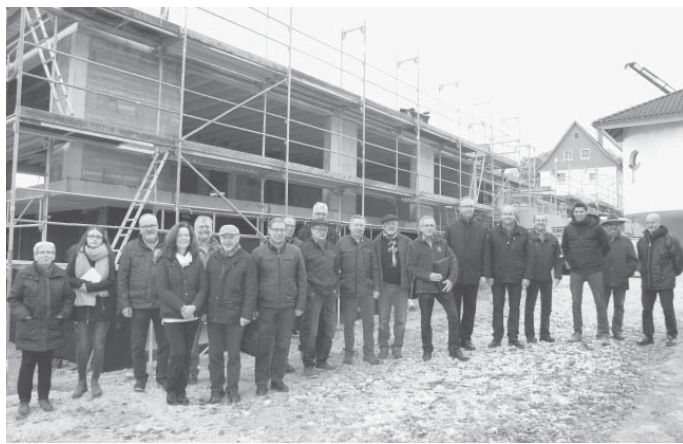
Der Technische Ausschuss der Stadt Neresheim besichtigte den Baufortschritt an der katholischen Kindertagesstätte in Neresheim, einer der Investitionsschwerpunkte 2016.
