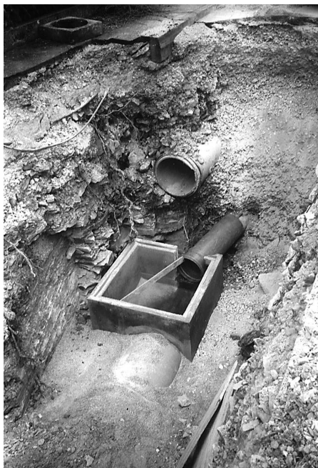
Das bisher voneinander getrennte Schmutz- und Regenwasser (die beiden oben liegenden Rohre) wurden in Elchingen zu einem tiefer liegenden neuen Mischwasserkanal zusammengefasst.
